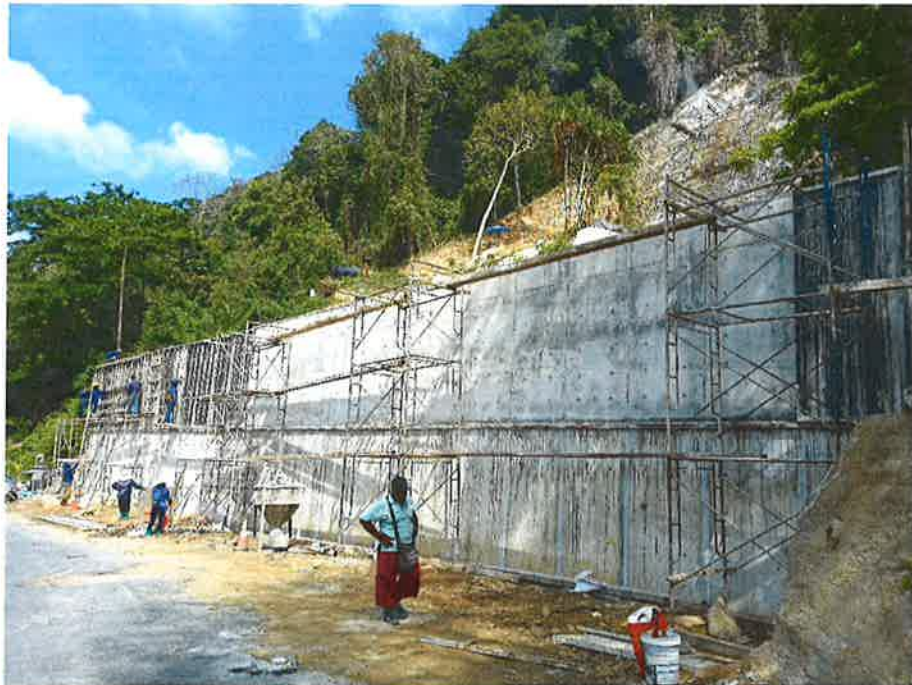
ภาพตัวอย่างการแก้ไขลาดดินพังด้วยวิธี Soil nail กำแพงกันดิน และระบบระบายน้ำ
