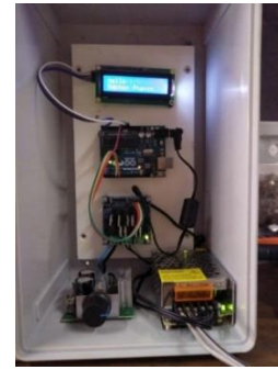
(ค) ชุดควบคุมมอเตอร์
