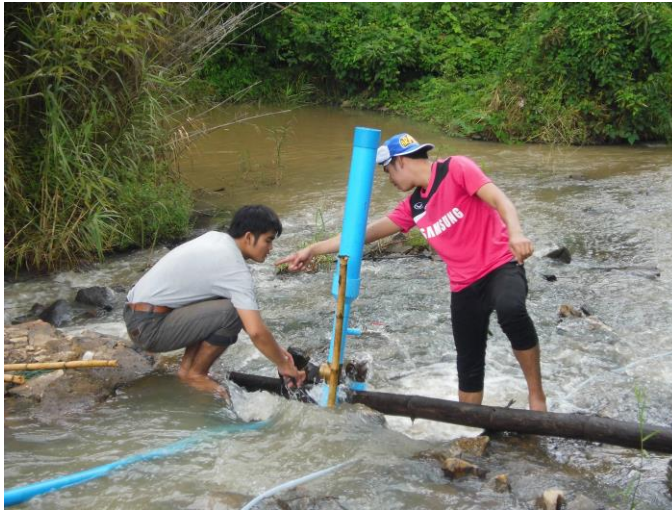
ภาพที่ 6 แสดงการติดตั้งและสูบน้ำโดยไฮดรอลิคแรมปั้ม
