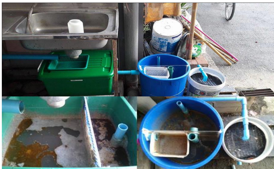
ภาพที่ 3 ลักษณะของระบบถังดักไขมันในช่วงเวลาใช้งาน
